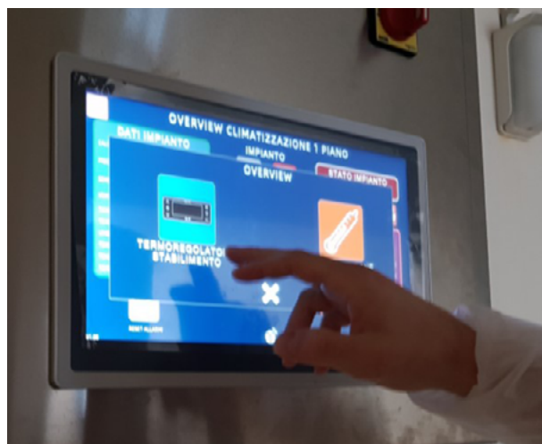
HMI di controllo per centrali frigorifere e impianti idraulici
